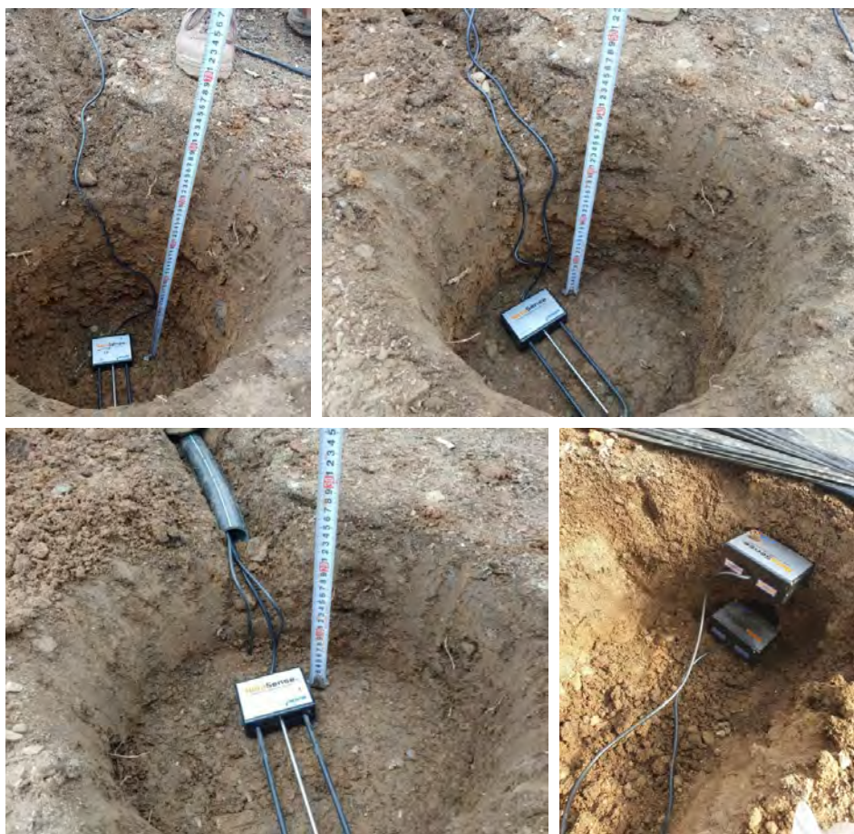
Obrázek 5. Postupná instalace tří snímačů půdní vlhkosti Netasense do vykopané jámy nad sebou a dvou snímačů do boční stěny výkopu (vpravo dole)
